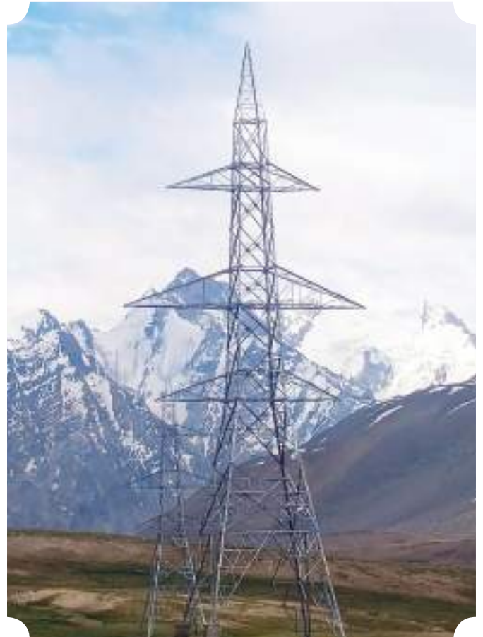
आरईसीपीडीसीएल द्वारा क्रियान्वित की जा रही कारगिल, लद्दाख में डबल सर्किट टॉवर पर द्रास से पदुम तक 220 केवी सिंगल सर्किट ट्रांसमिशन लाइन
